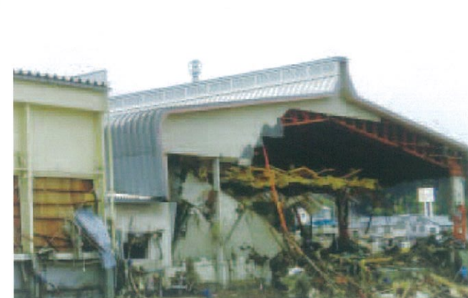
本社冷蔵庫 (1・2号冷蔵庫)
