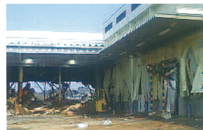
本社冷蔵庫 (3・4号冷蔵庫)
